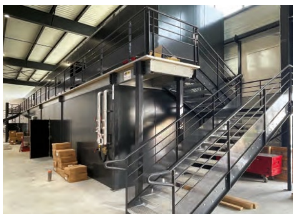
Passerelle de contrôle, installée au-dessus des zones machines avec accès ERP PMR (GBG Concept)
