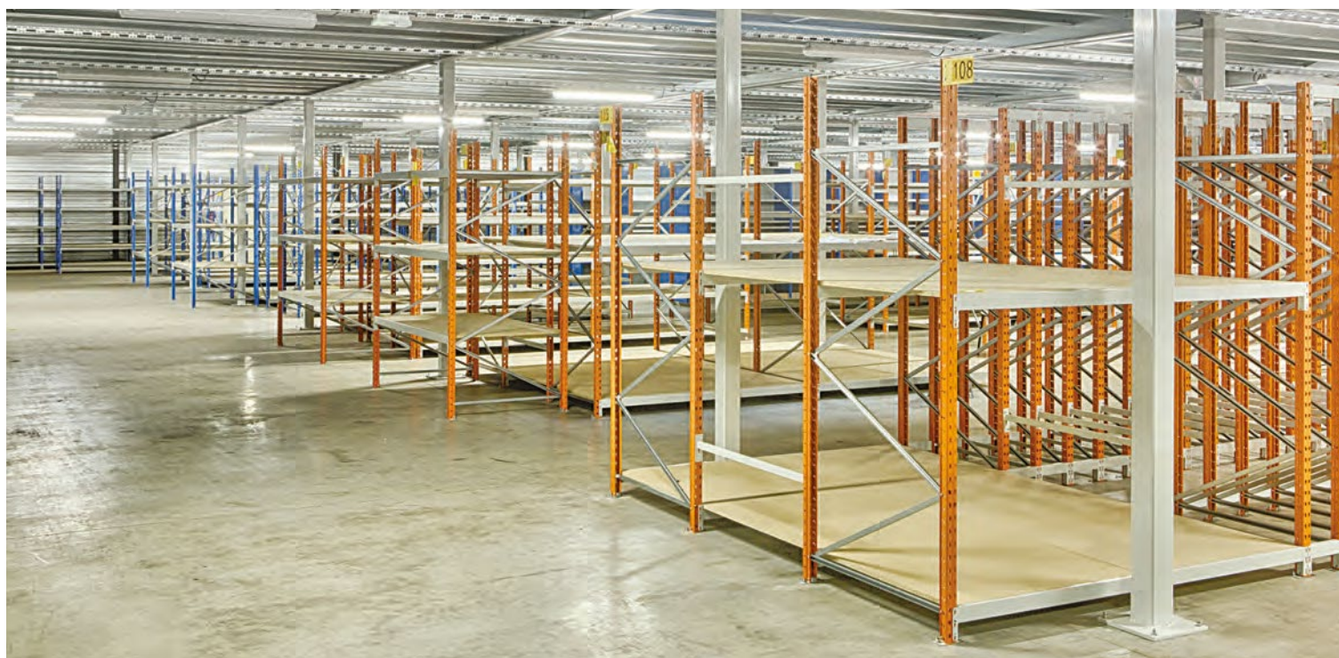
Installation multiple dans un entrepôt pour le stockage de différents types de produits et de volumes
