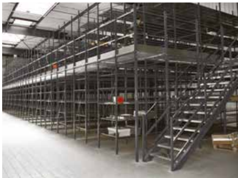
Implantation de rayonnages ACTI-PLUS sur deux étages, pour optimiser la surface de stockage de matières premières (Actiflip)
