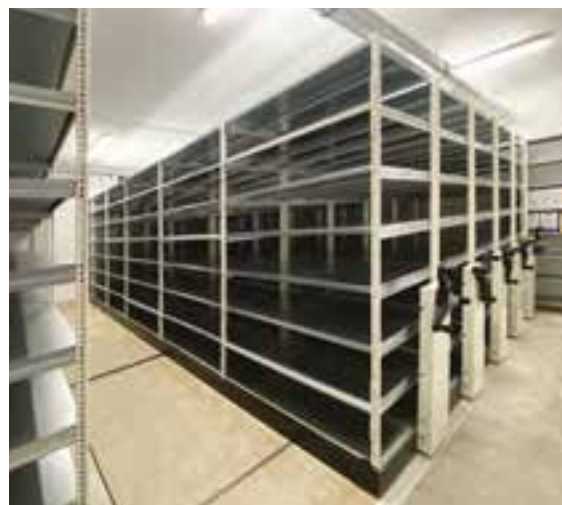
Installation mixte de rayonnages mobiles sur rails et de rayonnages fixes, 6 travées (Optim'Est)
